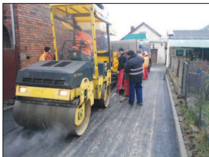
Zakończono prace remontowe drogi gminnej – łącznika pomiędzy ul. Konstytucji 3 Maja a ul. Tylną w Rydzynie. Wykonawcą było Przedsiębiorstwo Dróg i Ulic Sp. z o. o. z Lesznej, które wykonało prace za 39. 483 złote.
